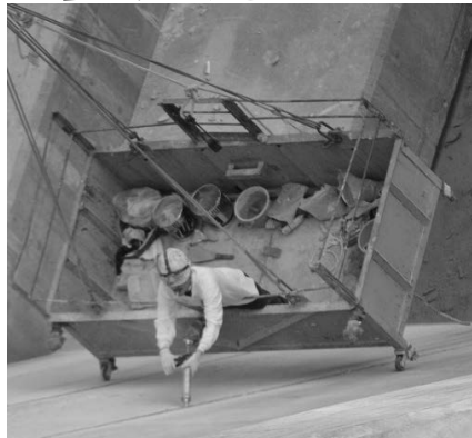
ひび割れ「補修」工事 ミルクセメントを注入か？ その後は左官用コテで取り繕うだけだった。
